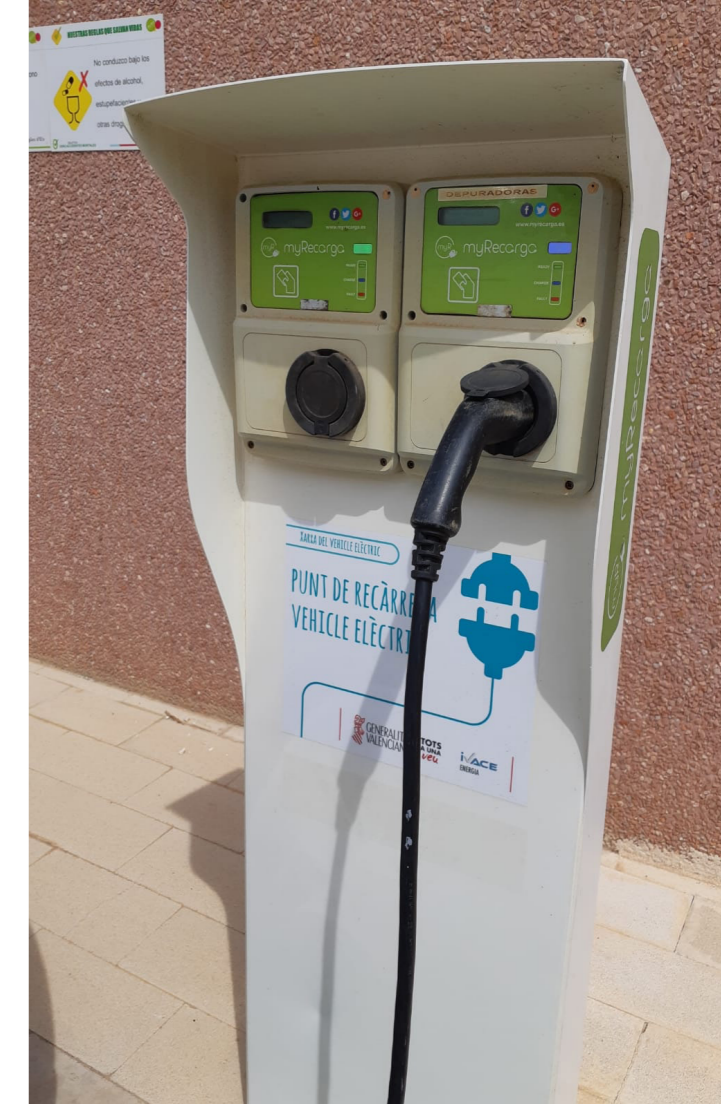
Electrolinera EDAR Arenales del Sol
